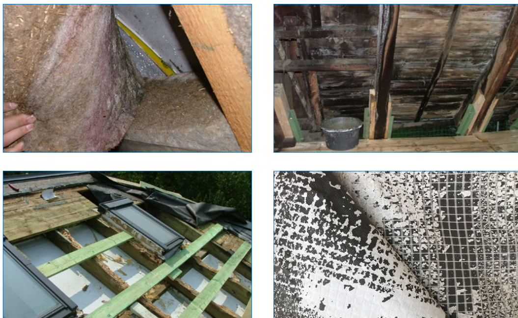
Obr. 2: Príklady poškodenia pri nesprávnom výbere poistnej hydroizolácie (zhora zľava, doprava nadol): vlhká a tým nefunkčná tepelná izolácia premočená z vonkajšej strany, tvorba plesní, poškodenie statiky krovu vlhkosťou a hnilobou, poškodená fólia nedostatočnou odolnosťou proti starnutiu
