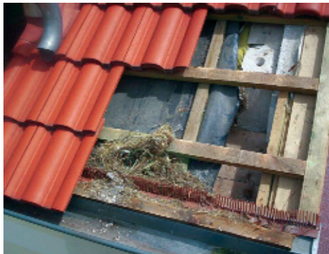
Рис. 8. Ошибка монтажа: проблема вентиляции из-за птиц
