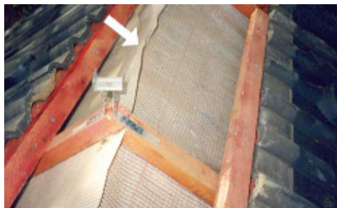
Рис. 6. Ошибка монтажа: отсутствие продуха в коньковой части пленки
