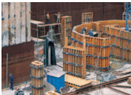
Подземный гараж гостиницы во Франкфурте: Вода, проникающая сквозь стену в грунт, отводится мембраной DELTA®-MS.
